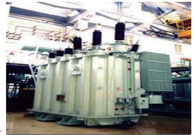
SF—PQY25MVA/110KV 铁道平衡牵引变压器
